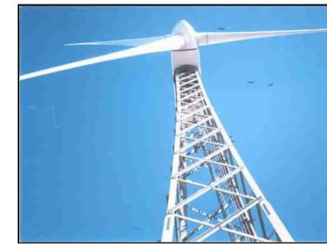
Photo 2 : Parc éolien d'Al Koudia Al Baïda (Maroc) Survol de l'éolienne 73 par un groupe de Vautours fauves ( Gyps fulvus ) à très basse altitude (A. El Ghazi - GOMAC, 2001)
